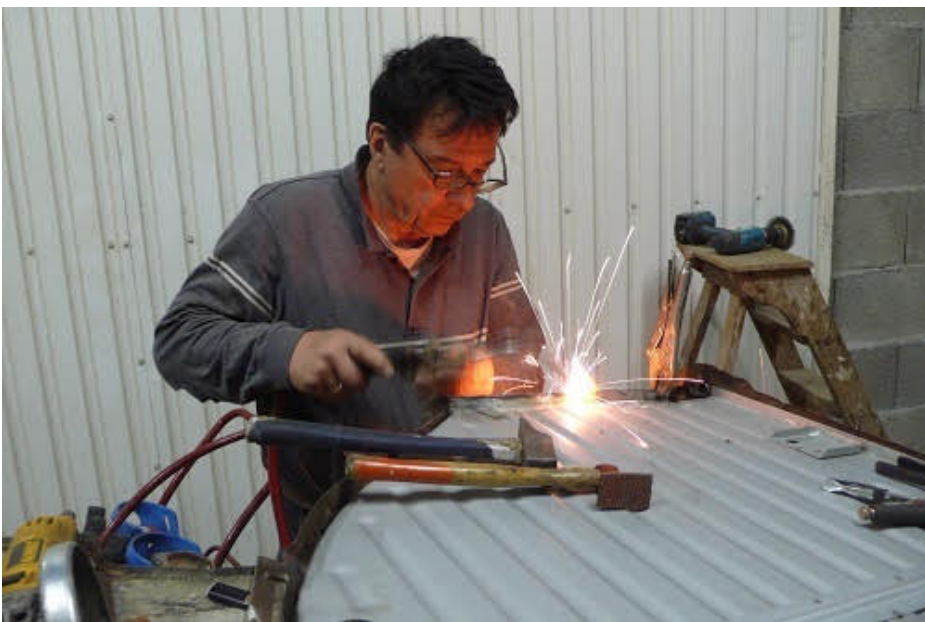
Aaaahhhh, c'est le début de la reconstruction. Un nouveau fond de coffre
